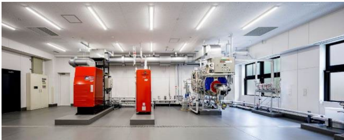
▲ボイラ実習室(B-TEC OSAKA):業界団体の技術講習会や、営業による見学会などが行われる。
