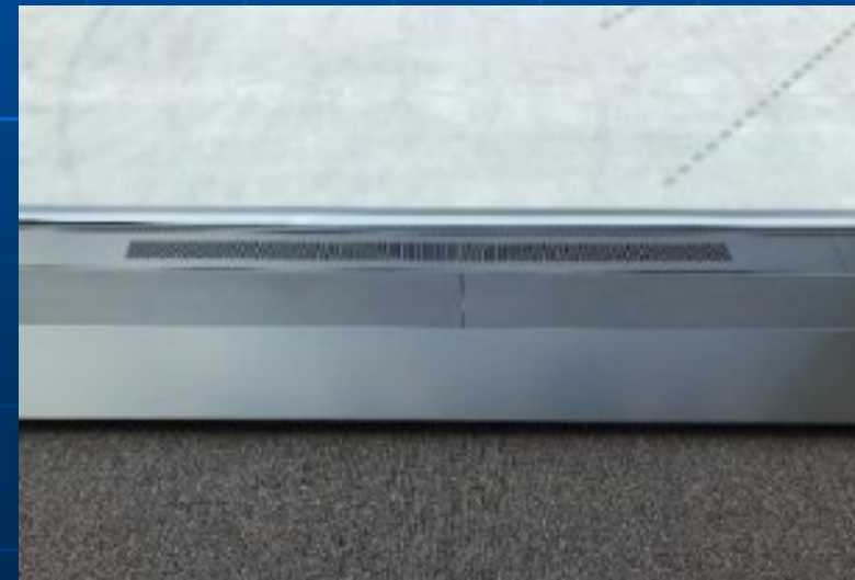
自動制御で開閉する自然換気給気口(南面)
