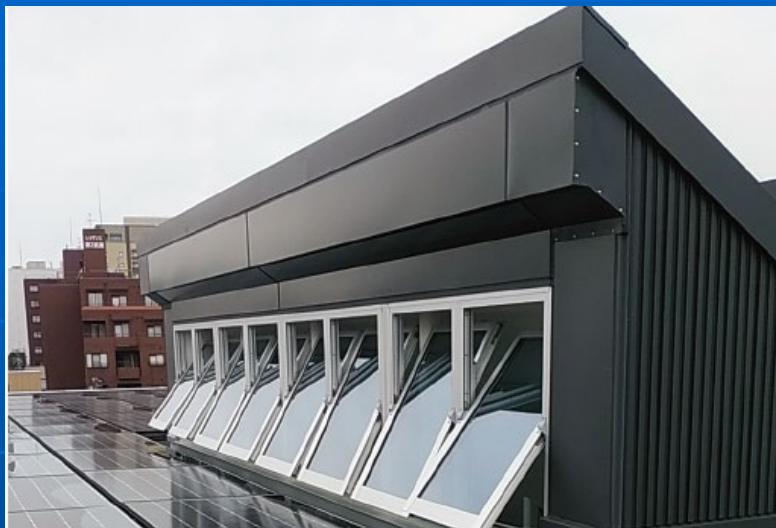
ハイサイドライトを兼用した自然換気排気口
