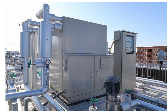
井水利用水冷HPチラー
