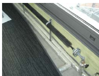
窓下温水放射暖房配管 温水高効率放射配管
