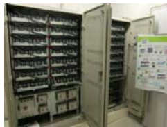
リチウムイオン蓄電池システム50kWh ※カレンダー設定機能による自動運転が可能
