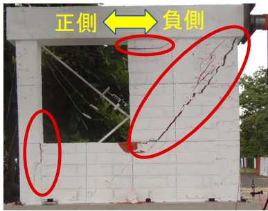
実験における損傷状況
