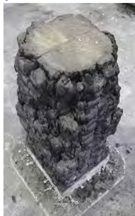
加熱を受けた柱の断面
