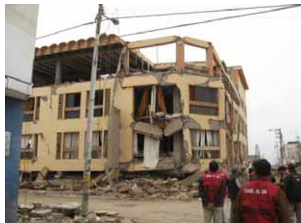
ホテル (Hotel Embassy) の被害
