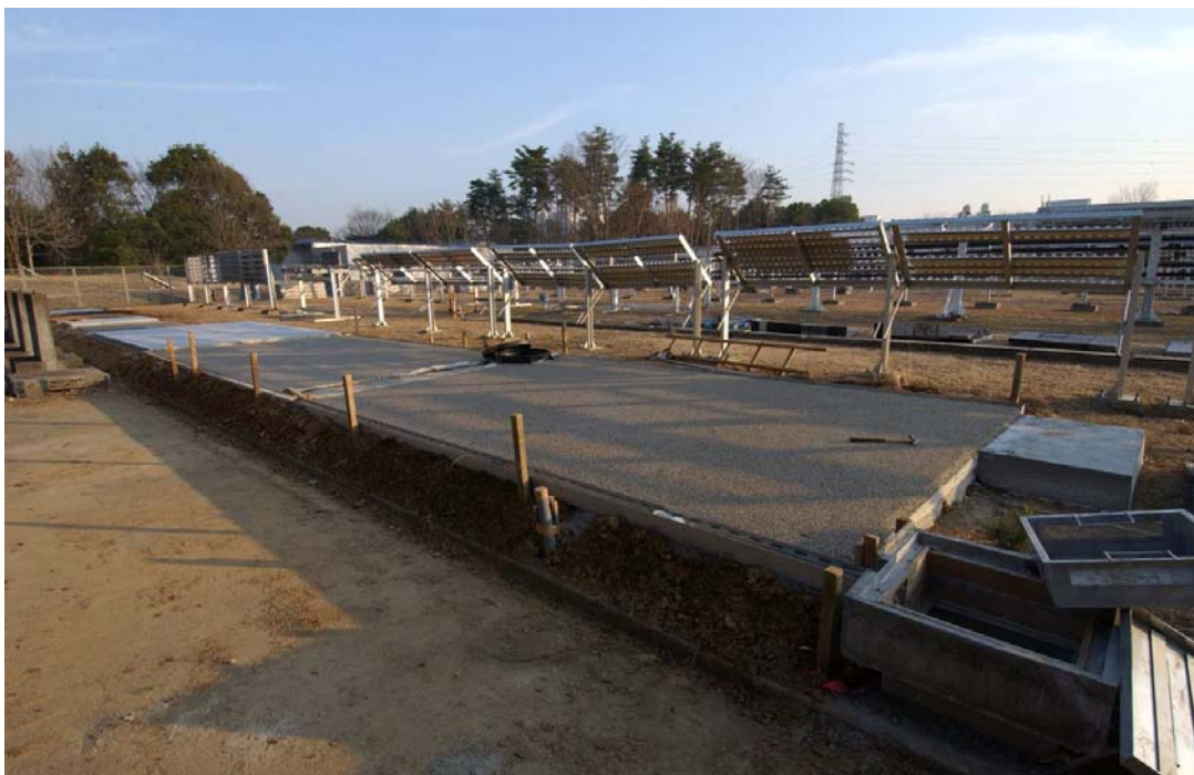
写真1 「涼感舗装」の実験施設全景（独立行政法人建築研究所・暴露試験場内に設置）
