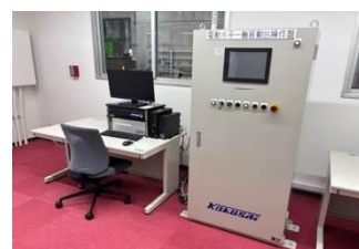
加振制御室の制御装置
