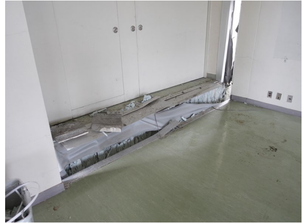
写真 8.4 建物の傾斜による 2 階のエクspansion ジョイントの破損
