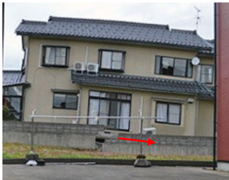
i) 側方流動による住宅の傾斜と擁壁の亀裂
