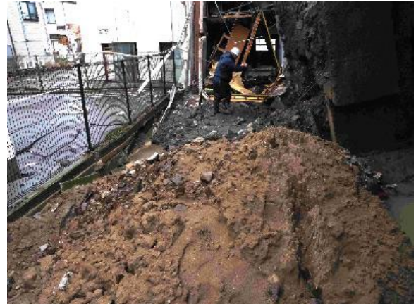
写真 6.6 地表面の変状 (敷地の南側)
