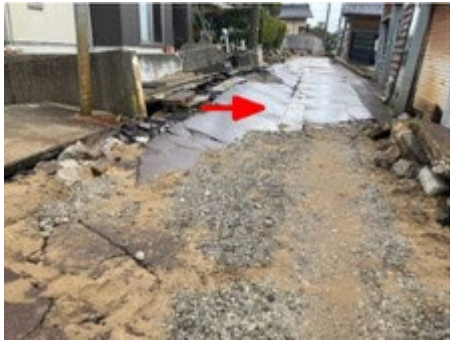
e) 側方流動した地盤
