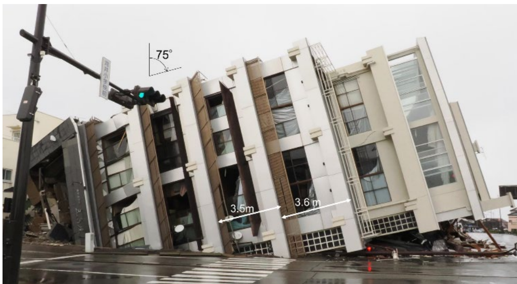
写真 6.2 転倒した建物（南側から撮影）
