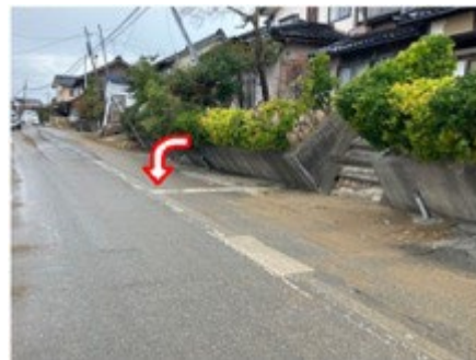
h) 傾斜した擁壁
