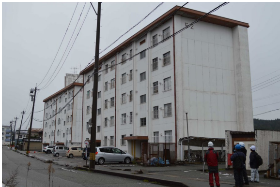
写真 9.1 川側（紙面の奥向き）に傾斜した壁式 RC 造の板状住宅（左側の建物）
