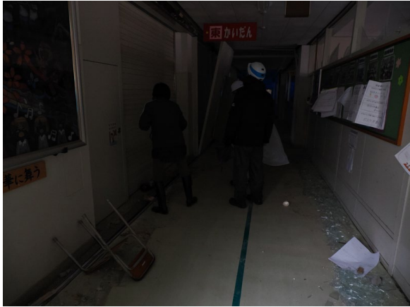
写真 8.3 建物内部のガラスの散乱状況
