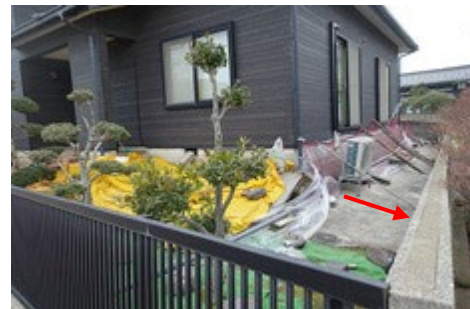
n) 住宅周辺の地盤変状
