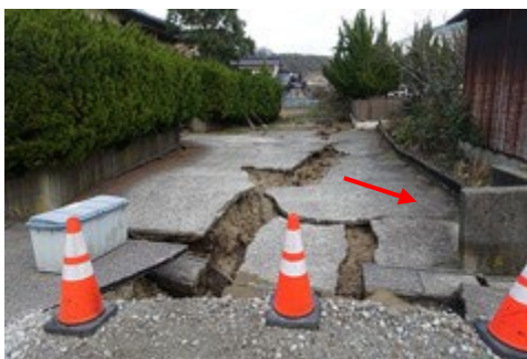
o) 側方流動した地盤と地割れ
