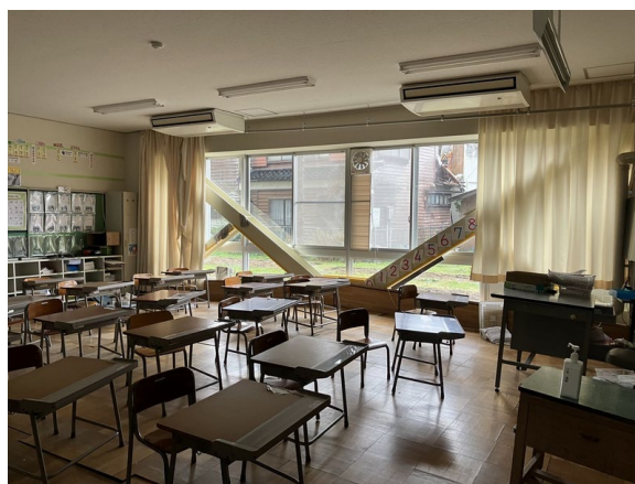
写真 8.2 1 階での床の盛り上り
