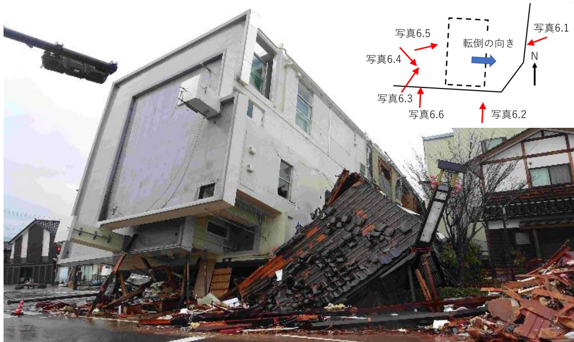
写真 6.1 転倒した建物（東側から撮影）
