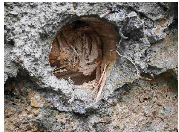
b) パイルキャップ部に残った杭の一部
