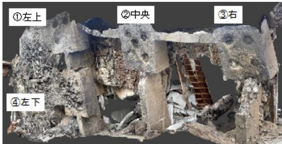
図 6.2 引き抜かれて露出した基礎部分の全景 (Lidar スキャナにより取得)
