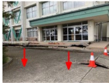
f) 周辺地盤が沈下した建物
