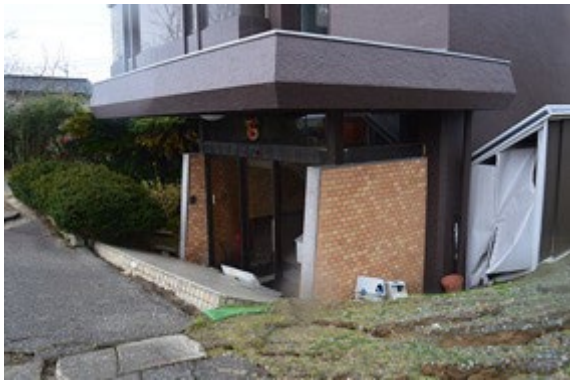
写真 5.4 正面入口付近の状況（沈下）
