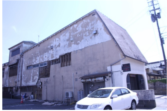
写真 6.5.2 店舗の外装材の崩落
