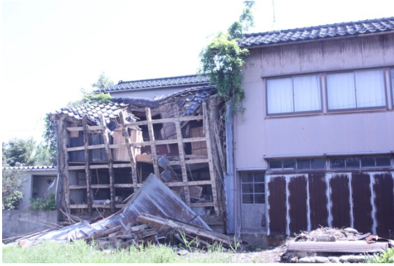
写真 6.5.1 増設した納屋の外壁の崩落
