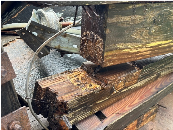
写真 6.2.5 写真 6.2.4 の住宅の腐朽・蟻害
