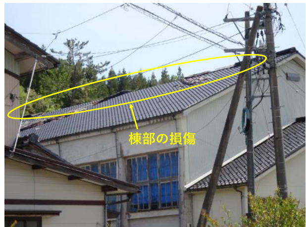
写真 8.5.6 小学校の体育館の屋根被害 (珠洲市正院町正院)
