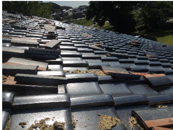
写真 8.2.7 脱落したのし瓦(1)
