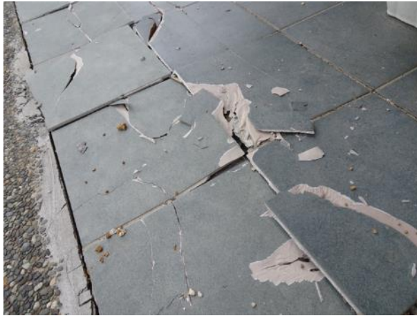
写真 8.4.5 玄関床部での被害
