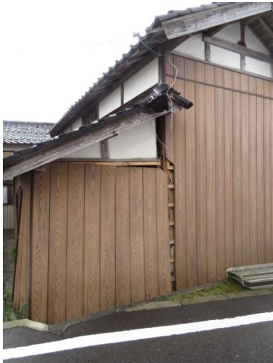
写真 6.2.11 外壁と下屋部分が外れかけた住宅
