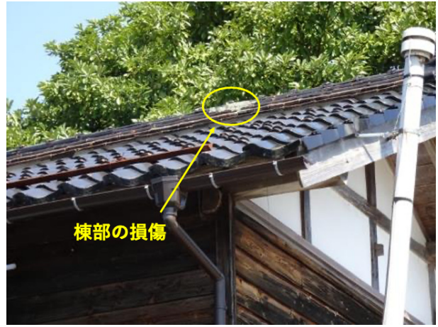
写真 8.5.2 棟部の被害 (珠洲市正院町正院)
