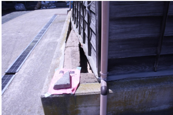
写真 6.2.22 基礎から大きくずれた納屋
