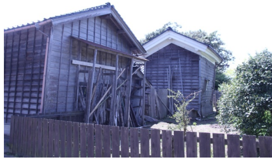
写真 6.2.21 傾斜した納屋
