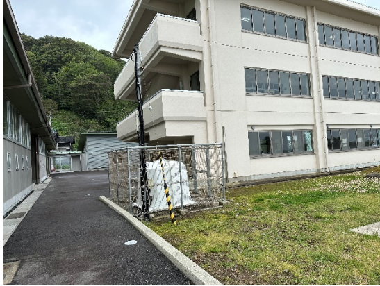
写真 7.4.1 地震計設置状況
