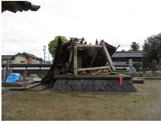
写真 6.2.15 倒壊した鐘楼
