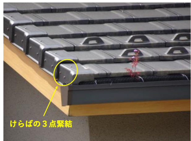
写真 8.4.4 瓦の緊結状況
