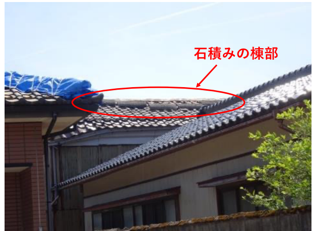
写真 8.5.4 石積みの棟の倒壊 (珠洲市正院町正院)
