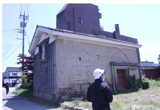
写真 6.4.4 納屋の外壁の剥落
