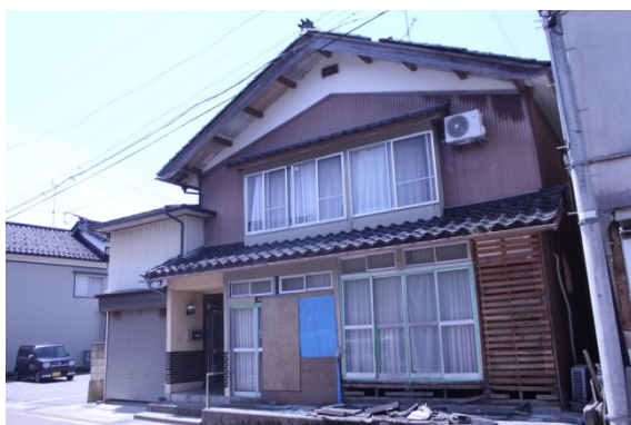
写真 6.4.3 住宅の外壁の剥落と開口の破損
