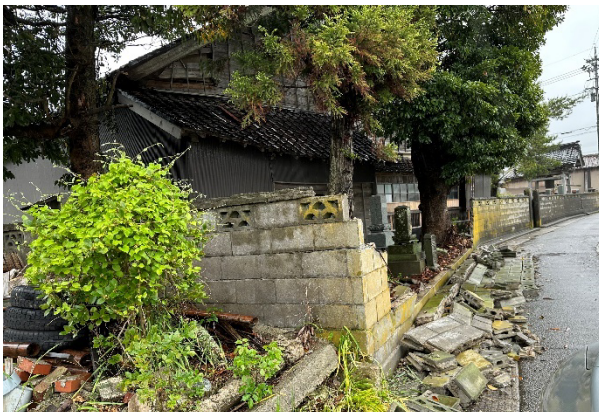
写真 7.1.3 ブロック塀の倒壊
