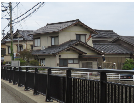
写真 7.4.5 外壁に割れが生じた住宅
