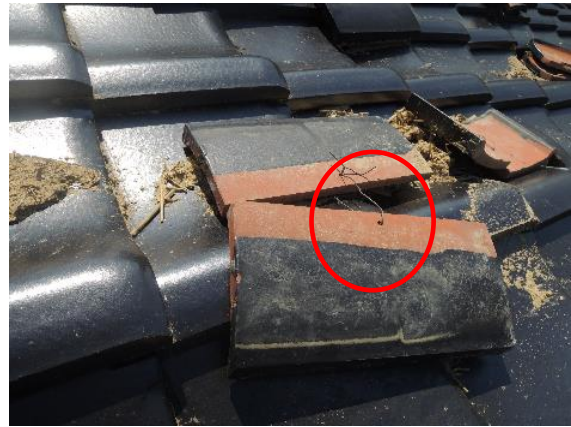
写真 8.2.8 脱落したのし瓦(2)
