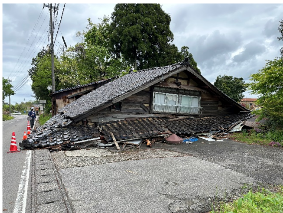
写真 6.3.1 三崎町二本松の倒壊住宅
