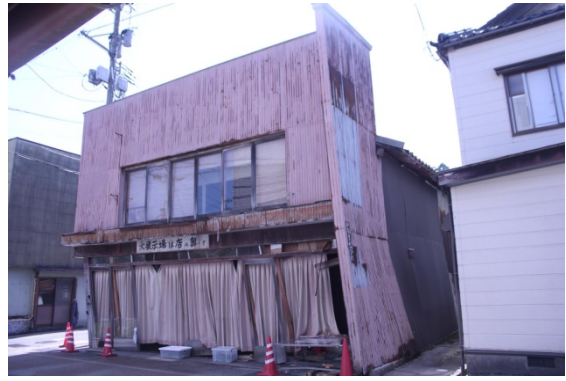
写真 6.5.4 店舗併用住宅の傾斜
