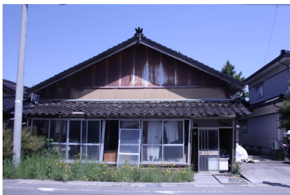
写真 6.4.1 住宅の傾斜：1/20 rad
