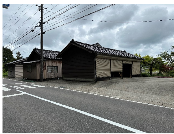
写真 6.3.2 写真 6.3.1 近傍の残留変形がある車庫
