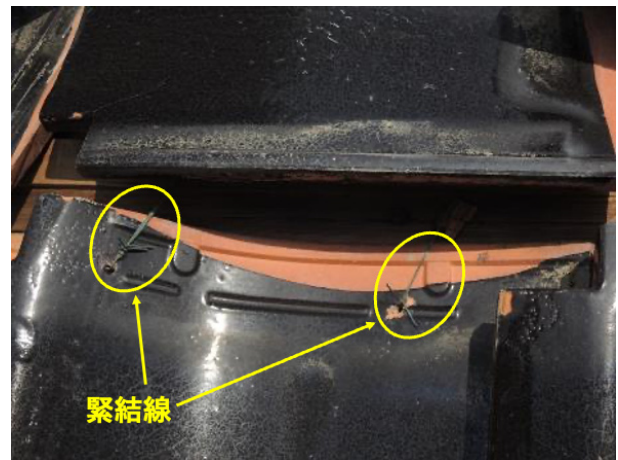
写真 8.6.6 鐘撞堂の屋根瓦の緊結状況 (珠洲市正院町正院)
