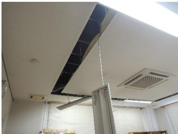
写真 8.6.1 吊り天井での照明器具の脱落 (珠洲市正院町正院)
