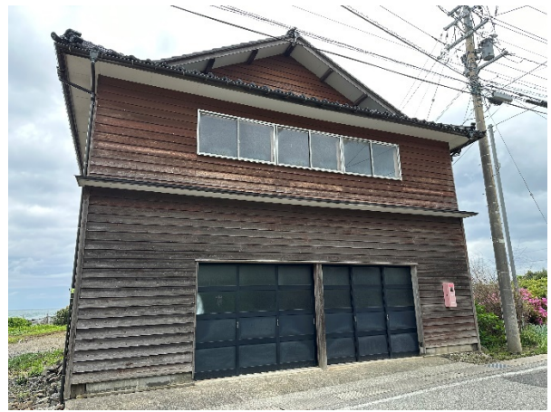
写真 7.2.2 残留変形のある倉庫
