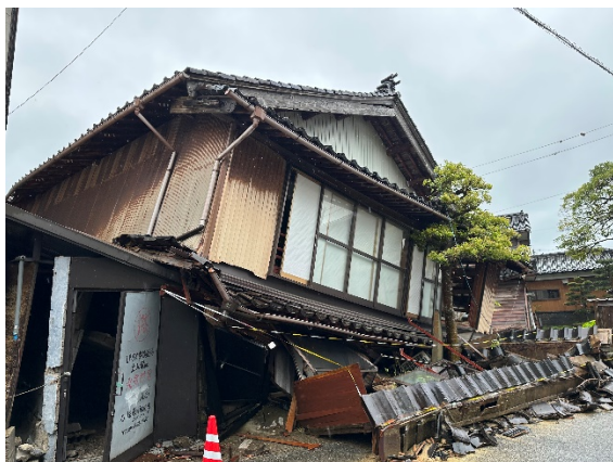
写真 6.2.1 正院町正院の倒壊住宅
