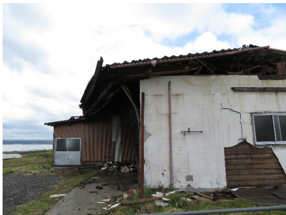
写真 6.2.18 写真 6.2.16 の倉庫の倒壊した小屋組
