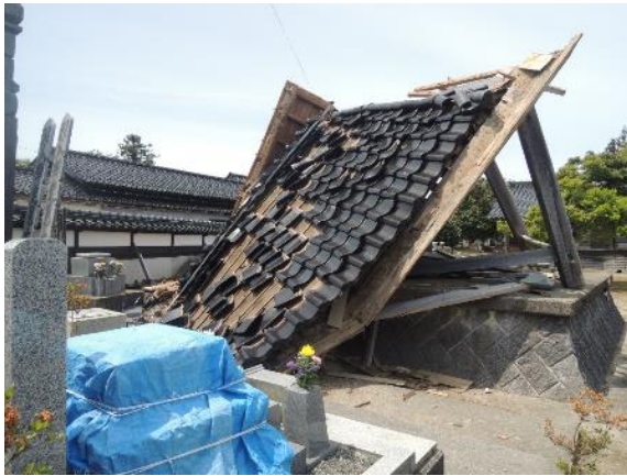
写真 8.6.5 鐘撞堂の被害 (珠洲市正院町正院)
