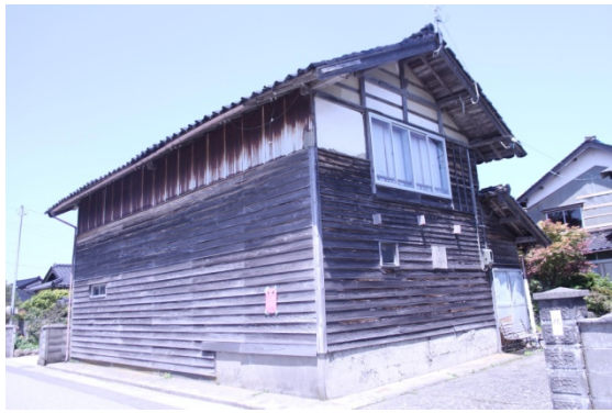
写真 6.2.20 傾斜した住宅
