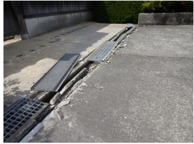
写真 8.4.6 住宅 B の側溝の被害
