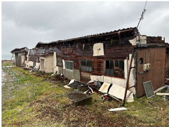
写真 6.2.16 屋根が崩壊した大規模倉庫
