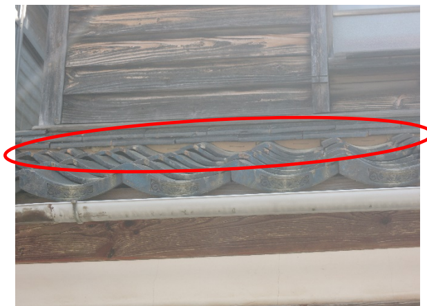
写真 8.1.1 表面にモルタルが塗布されていない 面戸瓦の例
