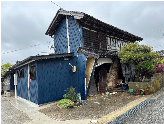
写真 6.2.7 残留変形の大きい住宅
