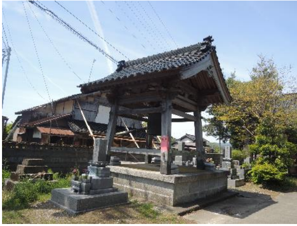
写真 8.6.3 鐘撞堂の被害 (珠洲市正院町正院)
