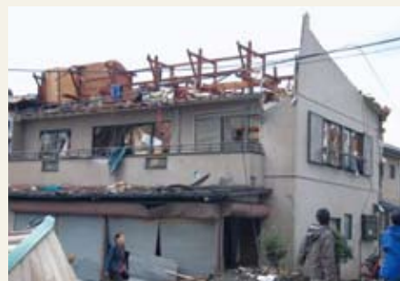
写真1 竜巻による小屋組の被害 (つくば市)
