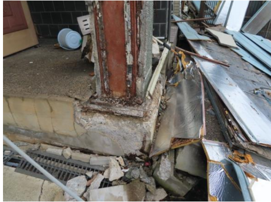
写真 5.5-81 露出柱脚のコンクリートの破壊
