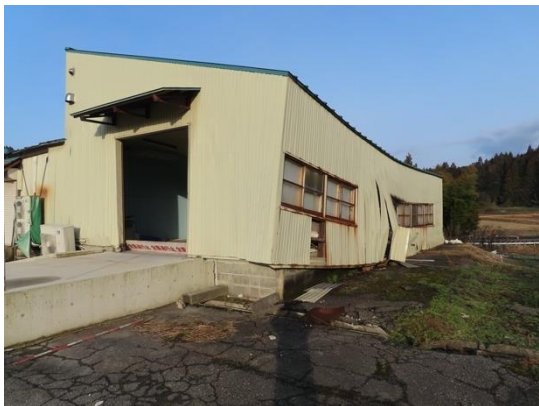
写真 5.5-36 側面の壁の基礎部分からの外れとはらみ出し
