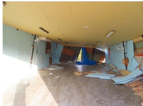
写真 5.5-37 床の沈下、傾斜
