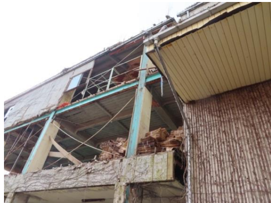
写真 5.5-68 ターンバックルブレースのたわみ
