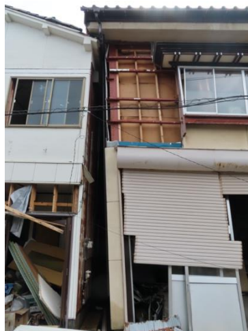
写真 5.5-21 建築物全体の傾斜と隣接建築物との接触
