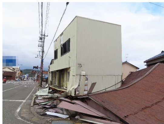
写真 5.5-10 1階の層崩壊（側面）
