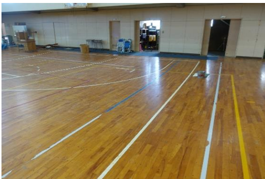
写真 5.5-145 第二体育館 床の沈下
