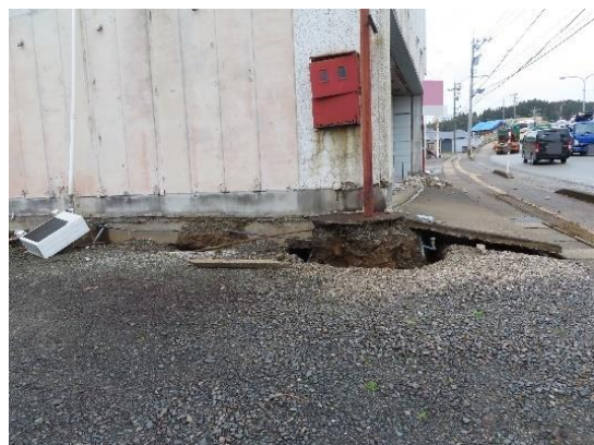
写真 5.5-73 建築物が隆起したと思われる被害
