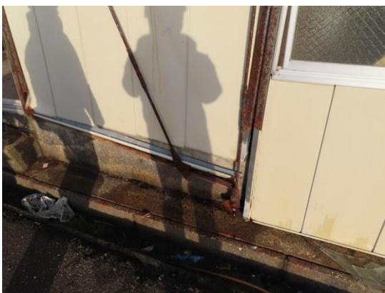
写真 5.5-84 溝形鋼組立て材柱の錆と破断
