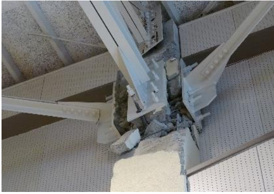
写真 5.5-130 RC 造柱のコンクリートの破壊、脱落、アンカーボルトの抜け出し
