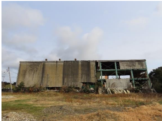
写真 5.5-65 建築物背面の外壁の脱落
