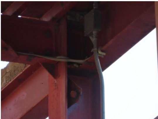
写真 5.5-55 柱梁接合部の状況、ブレース羽子板部破断（ボルトが残っている）
