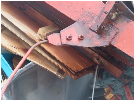
写真 5.5-7 ターンバックルブレース接合部分
