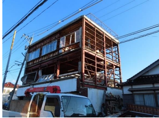
写真 5.5-54 建築物側面の広範囲で外壁脱落
