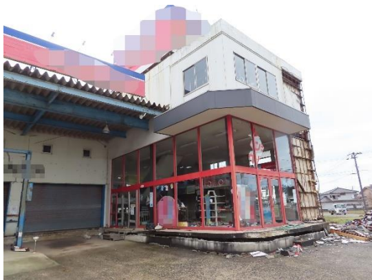
写真 5.5-113 建築物が隆起したと思われる被害
