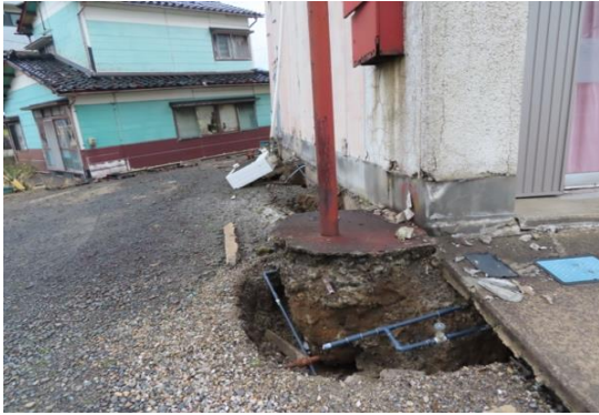
写真 5.5-74 建築物が隆起したと思われる被害
