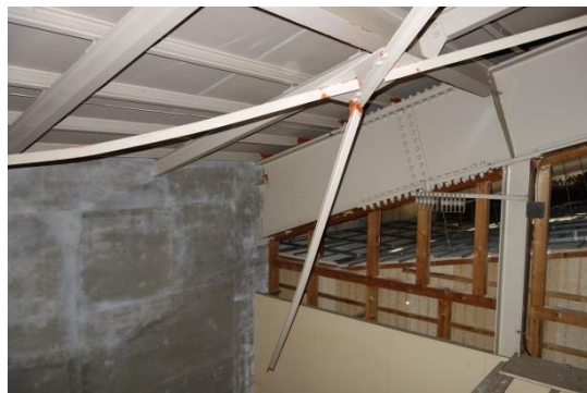
写真 5.5-155 水平ブレース端部の破断
