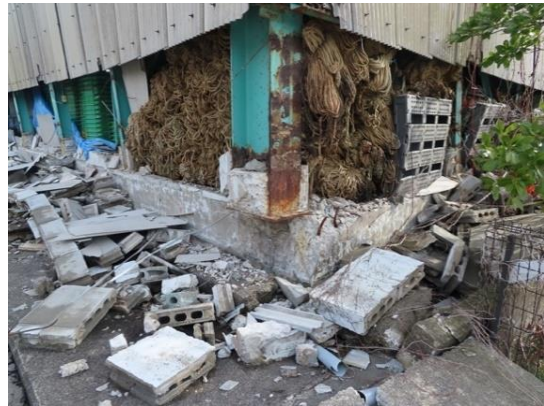
写真 5.5-66 柱脚のアンカーボルト破断、コンクリート破壊、移動
