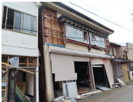
写真 5.5-23 建築物前面の外壁の脱落、シャッター破損、窓ガラス、窓枠の破損
