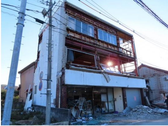
写真 5.5-53 建築物前面の外壁、窓ガラスの脱落
