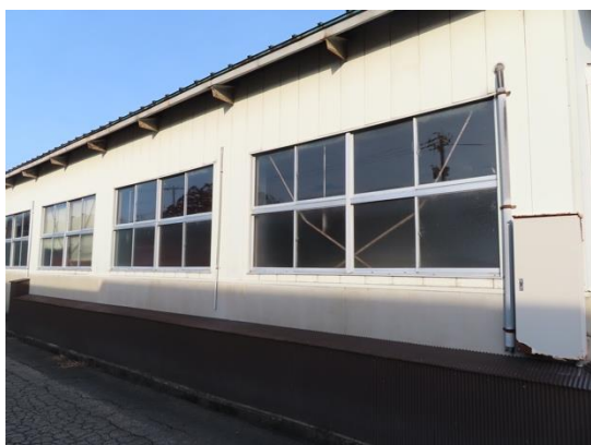
写真 5.5-88 ブレースの座屈
