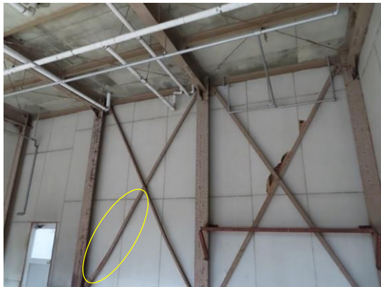
写真 5.5-61 山形鋼ブレースの変形
