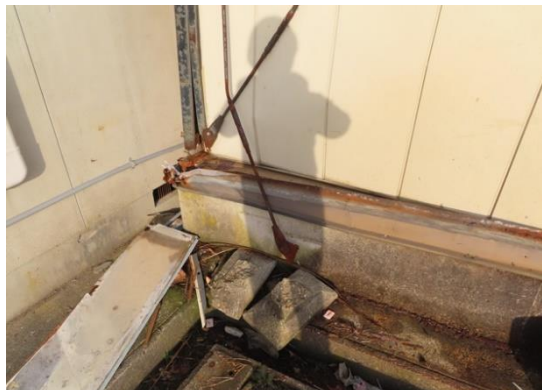
写真 5.5-83 ターンバックルブレースの座屈及び溶接接合部の破断
