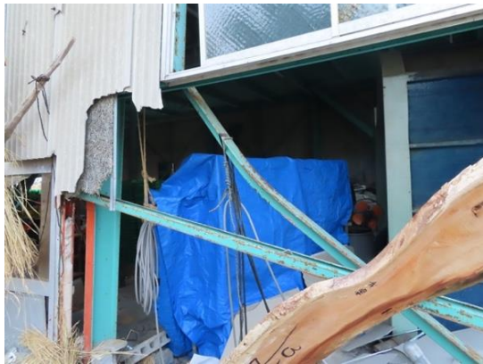
写真 5.5-67 山形鋼ブレース座屈
