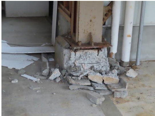
写真 5.5-59 露出柱脚のアンカーボルト破断、コンクリート破壊
