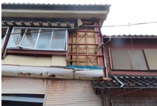
写真 5.5-22 ターンバックルブレースの状況
