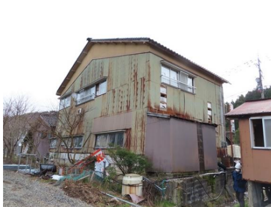
写真 5.5-25 建築物の裏側からは大きな残留変形(たわみ)が見られた
