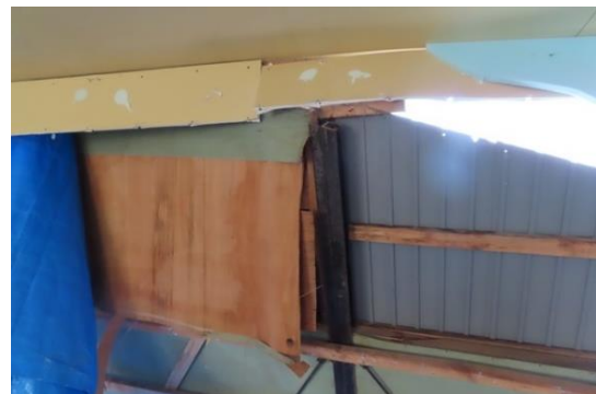
写真 5.5-39 内壁及び窓枠破損（建築物内の奥の内壁）
