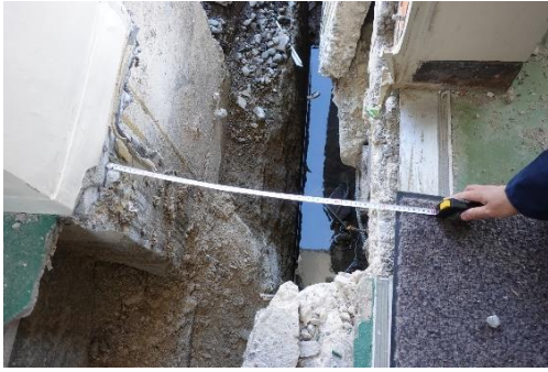
写真 5.5-141 第一体育館と第二体育館 の通路の損傷による約 60cm の隙間
