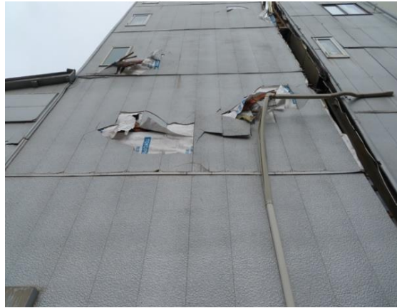
写真 5.5-45 平鋼ブレースの湾曲変形とそれによる外装材の破損
