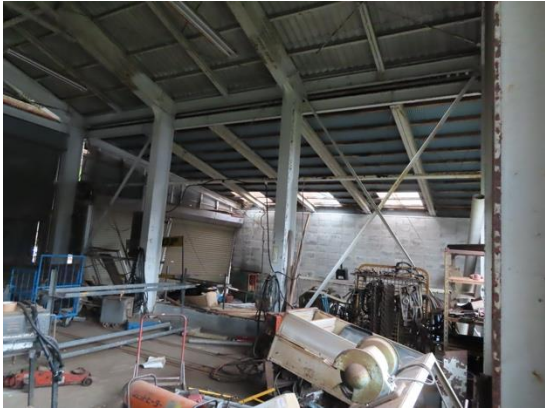
写真 5.5-94 山形ラーメンの柱梁及び山形鋼ブレースには大きな損傷は無い
