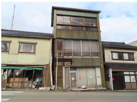
写真 5.5-27 外観（建築物全体の傾斜）
