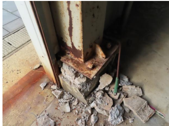
写真 5.5-60 露出柱脚のアンカーボルト破断、コンクリート破壊
