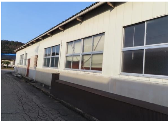
写真 5.5-87 ブレースの座屈
