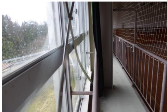
写真 5.5-152 ブレースのたわみ
