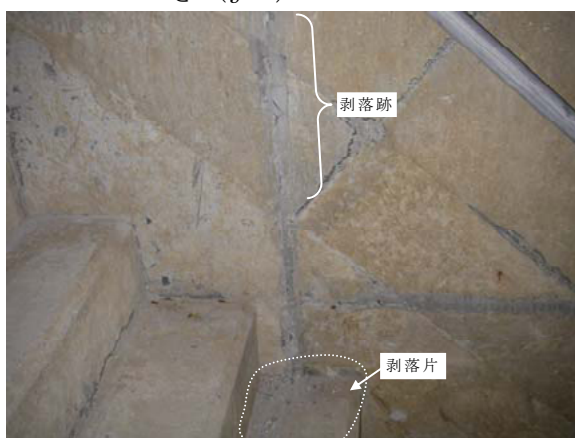
写真-5.4 ハケ川ダム監査廊継目部における補修モルタルの剥落（J-3）
