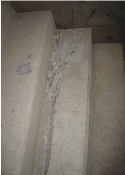
写真-5.5 八ヶ川ダム監査廊継目における階段のクラック(J-8)
