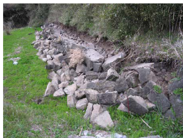
写真-5.11 Dため池下流法尻の土留(石積)の崩壊
