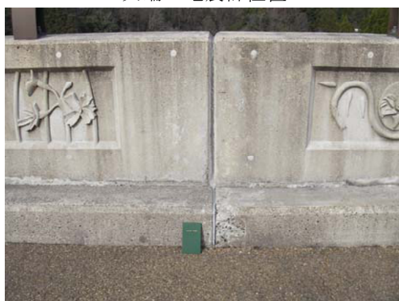
写真-5.3 ハケ川ダム天端高欄継目部のコンクリートの剥落（J-8）
