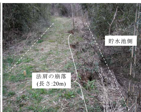
写真-5.10 Cため池堤体の法肩の崩落
