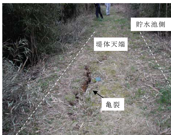
写真-5.9 Cため池天端の縦亀裂
