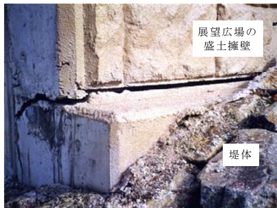
(a) 1993年能登半島沖地震後の状況 (擁壁と基礎コンクリートの開口幅:23mm)
