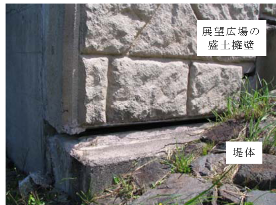
(b) 1993年能登半島沖地震後の状況 (擁壁と基礎コンクリートの開口幅:約50mm)
