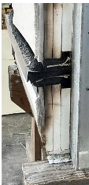
写真3 発泡による 通気口閉塞
