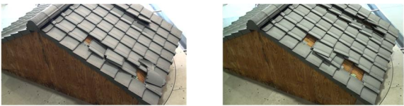
図4 飛散実験時の屋根瓦の脱落・飛散状況
