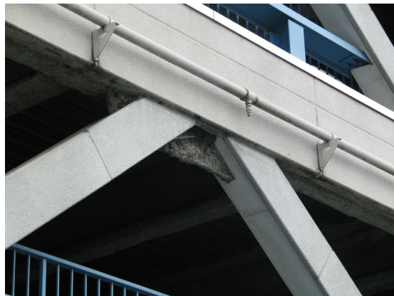
写真 6.149 ブレース材交差部の被覆材の脱落
