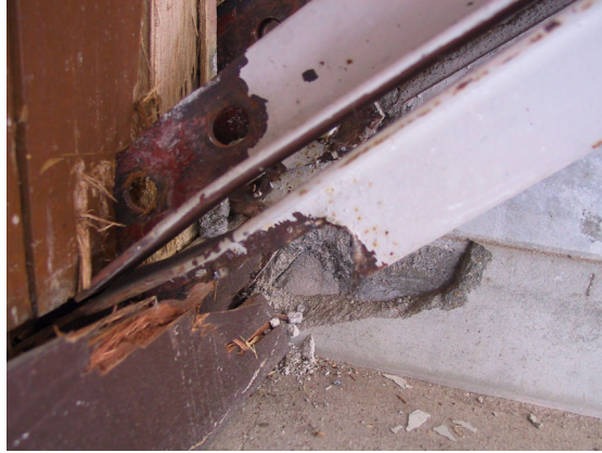
写真 6.10 ブレース材端部ボルト破断及び端抜け(29)
