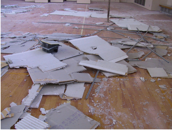
写真 6.78 落下した天井とスピーカー
