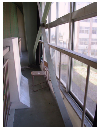
写真 6.45 ブレース材座屈(131)
