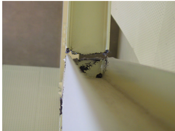
写真 6.101 ブレース交差部の溶接部破断 (119)
