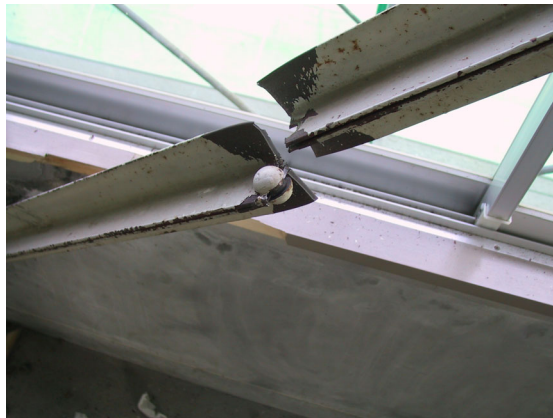
写真 6.61 ブレース材つづり部での破断 (25)
