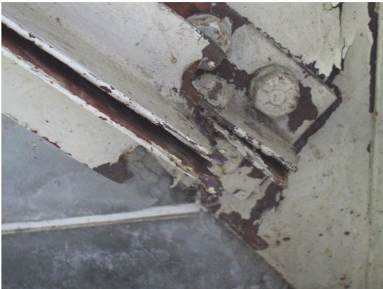
写真 6.56 ブレース材端部孔欠損部破断(18)
