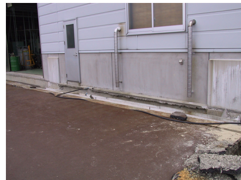
写真 6.114 周辺地盤沈下
