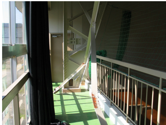
写真 6.129 ブレース材の座屈
