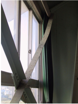
写真 6.41 ブレース材座屈 (126)
