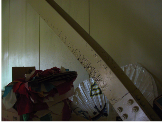
写真 6.110 ブレース材の座屈(19)
