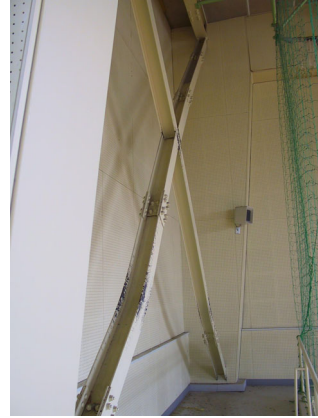
写真 6.99 ブレース材座屈(113)
