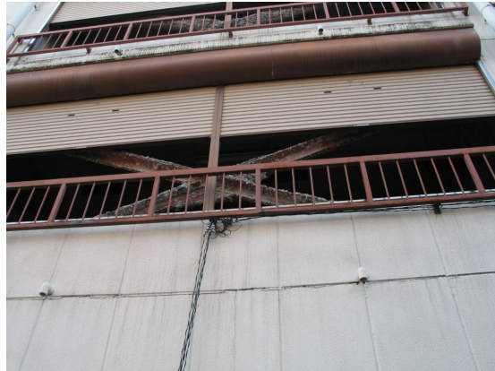
写真 6.150 ブレース材の被覆材の脱落
