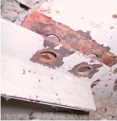
写真 6.3 ブレース材端部ボルト破断(11)
