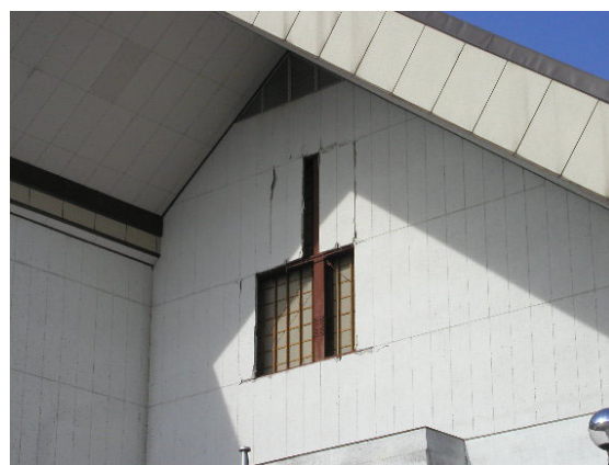
写真 6.146 ALCパネル（縦壁挿入筋構法）の落下
