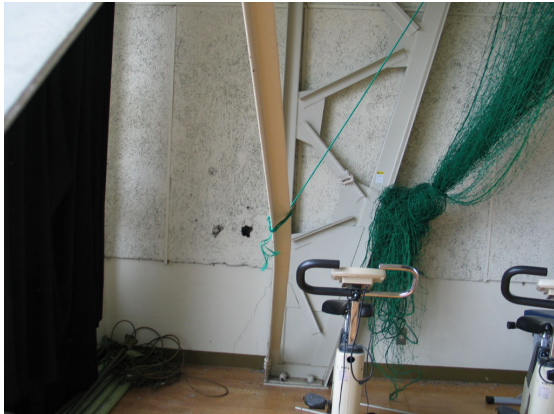
写真 6.138 ブレース材の座屈
