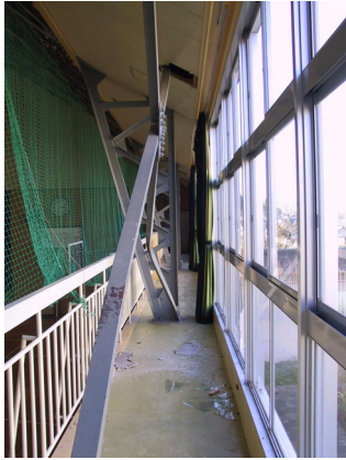
写真 6.27 ブレース材座屈(96)
