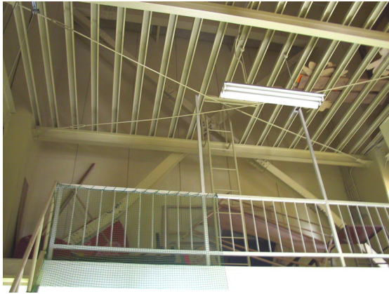
写真 6.94 ブレース材座屈(100)
