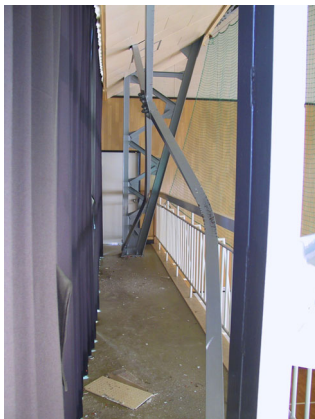
写真 6.35 ブレース材座屈(120)
