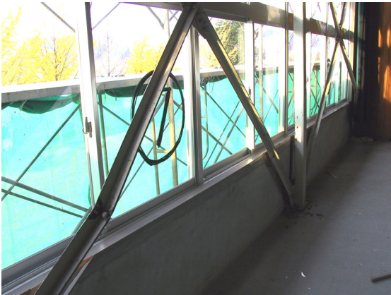
写真 6.72 ブレース材座屈(54)
