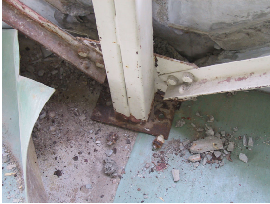
写真 6.70 間柱脚部アンカーボルト破断(49)
