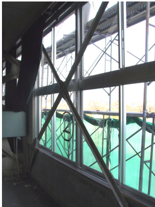
写真 6.60 ブレース材つづり部での破断 (24)
