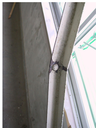
写真 6.63 つづり部の亀裂(31)
