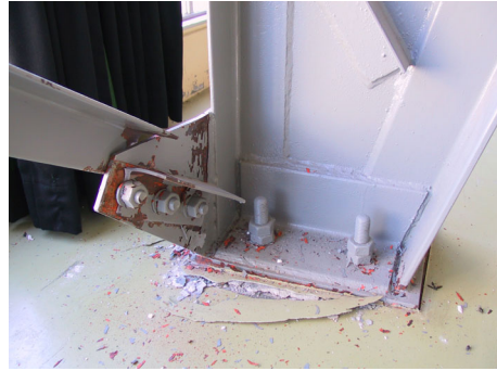
写真 6.26 ブレース材端部破断(93)
