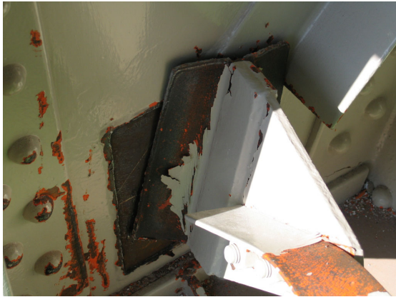
写真 6.130 柱とガセットプレート溶接 接合部の破断
