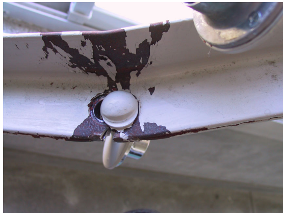
写真 6.6 つづり部での亀裂(18)
