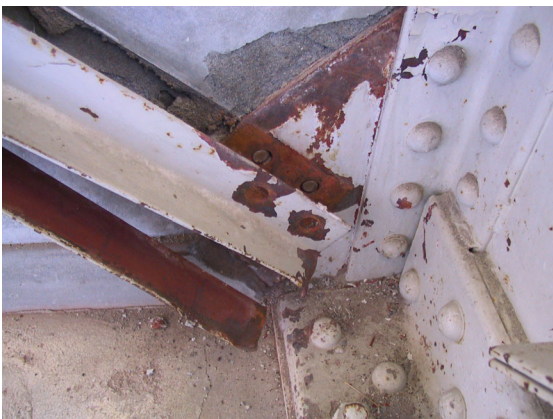
写真 6.7 ブレース材端部ボルト破断 (22)
