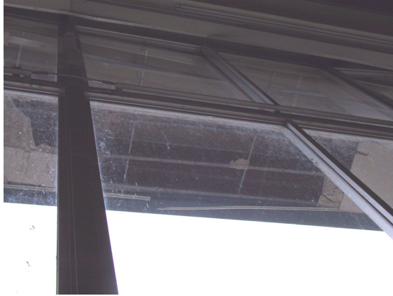
写真 6.98 軒の天井落下
