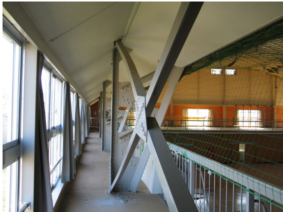
写真 6.122 ブレース材の座屈
