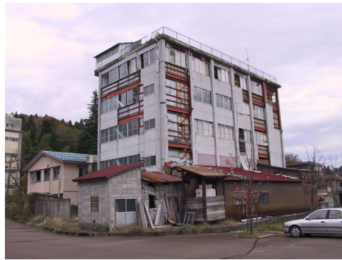
写真 6.115 工場Hに隣接する鉄骨造建築物 外装材脱落
