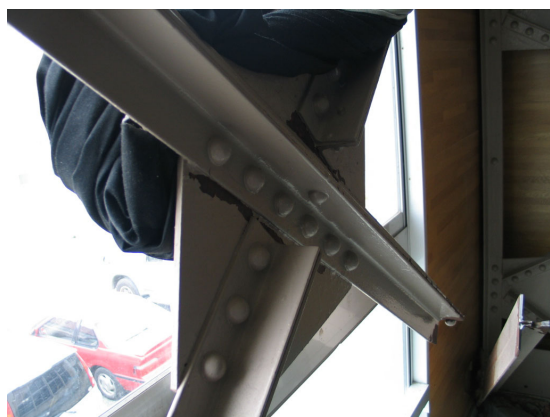
写真 6.140 ブレース材のボルト孔欠損部からの破断とガセットプレートの降伏
