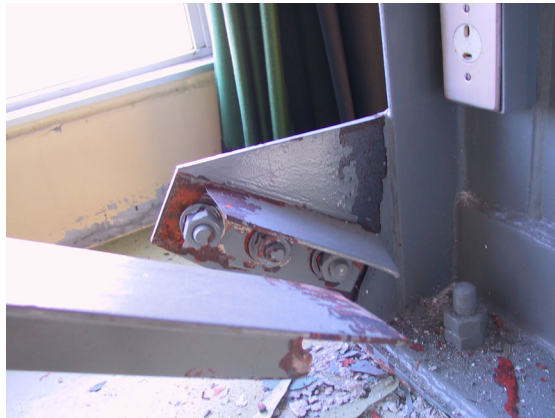
写真 6.30 ブレース材端部破断(101)
