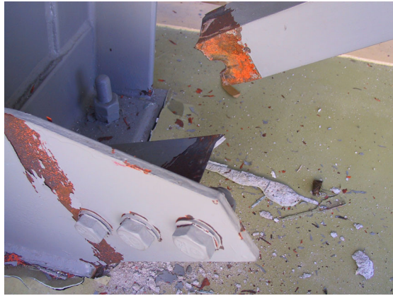
写真 6.28 ブレース材端部破断(98)
