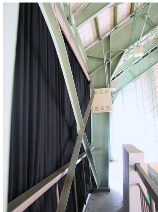
写真 6.50 ブレース材座屈(139)
