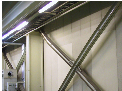
写真 6.112 ブレース材座屈
