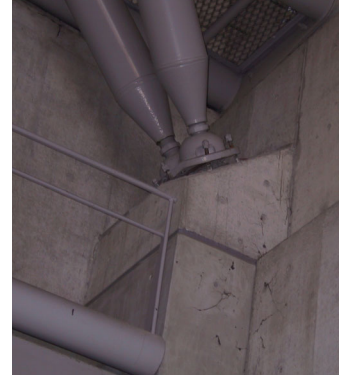
写真 6.23 アンカーボルトの伸び
