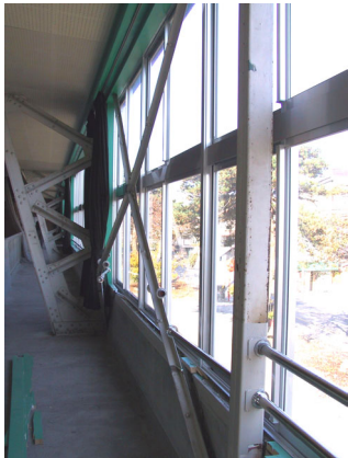
写真 6.5 ブレース材座屈(15)
