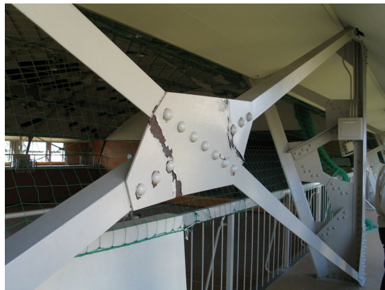
写真 6.123 ガセットプレートの座屈
