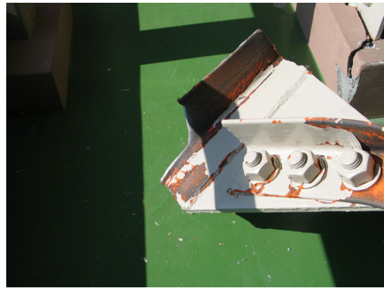
写真 6.131 接合部プレートの破断
