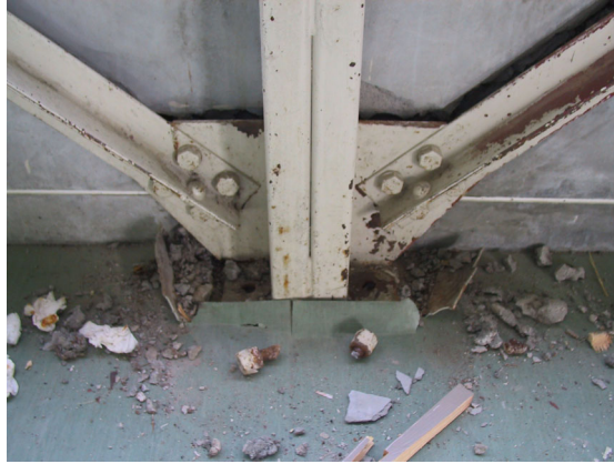
写真 6.59 間柱脚部アンカーボルト破断(22)
