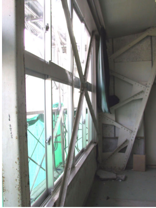
写真 6.58 ブレース座屈(21)
