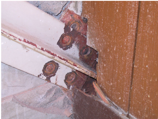
写真 6.13 ブレース材端部ボルト破断 (35)
