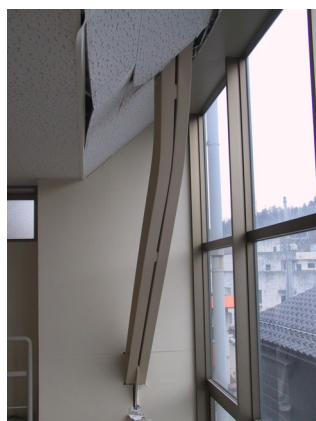
写真 6.88 ブレース材座屈(60)
