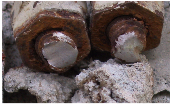
写真 6.65 破断したボルト(36)
