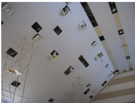
写真 6.145 システム天井の落下
