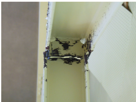
写真 6.102 ブレース交差部の溶接部破断(121)
