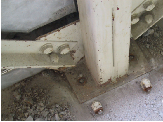
写真 6.64 間柱脚部ボルト破断(38)
