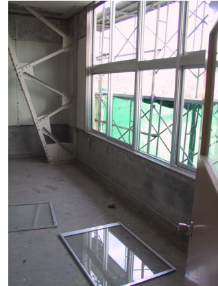
写真 6.67 窓サッシ脱落(42)
