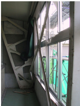
写真 6.68 ブレース材座屈(46)
