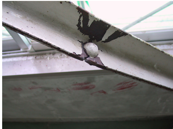
写真 6.57 ブレース材つづり部亀裂(20)
