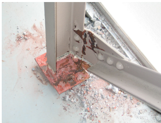
写真 6.141 間柱の脚部アンカーボルトの破断とガセットプレートの塑性化
