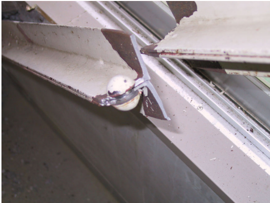
写真 6.66 ブレース材つづり部での破断(41)
