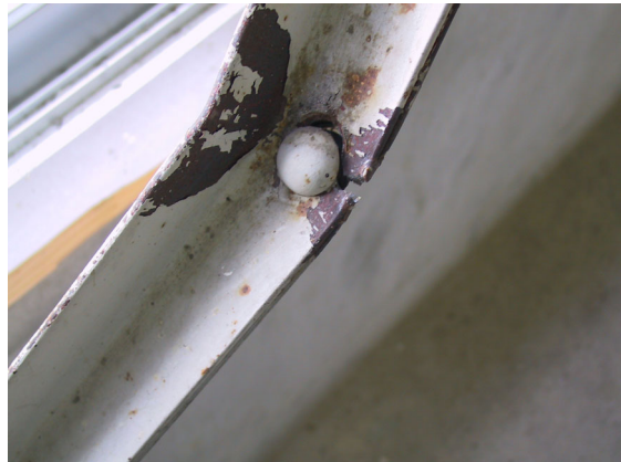
写真 6.73 つづり部の亀裂(55)
