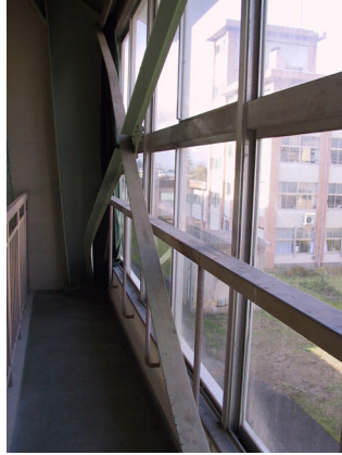
写真 6.46 ブレース材座屈(132)
