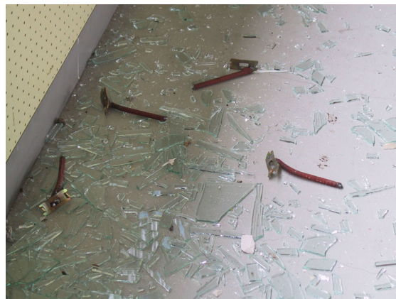
6.97 サッシを留めていたと思われる鉄筋と金具
