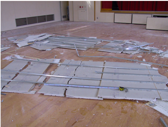
写真 6.80 落下した天井
