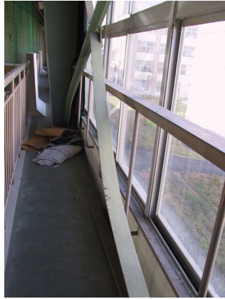
写真 6.42 ブレース材座屈 (127)
