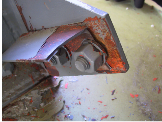
写真 6.32 ブレース材端部破断(110)
