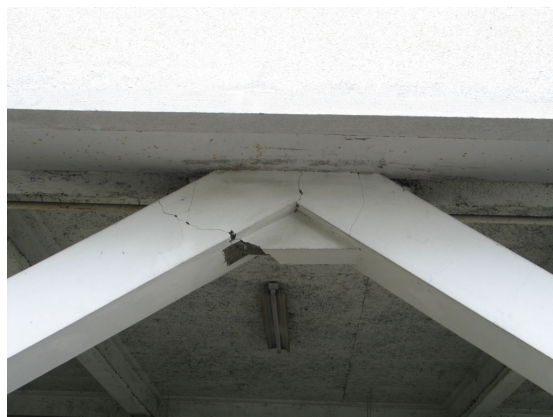
写真 6.151 ブレース交差部の被覆材の亀裂
