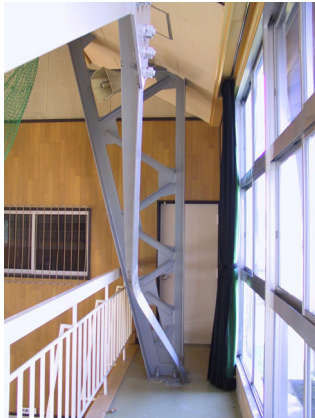
写真 6.29 ブレース材座屈(103)
