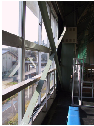
写真 6.48 ブレース材座屈(134)
