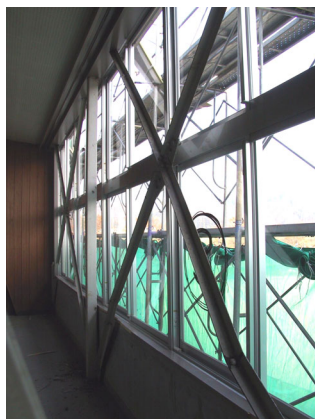
写真 6.62 ブレース材座屈(28)
