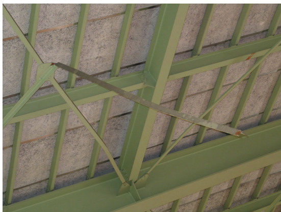
写真 6. 143 水平ブレース材の破断
