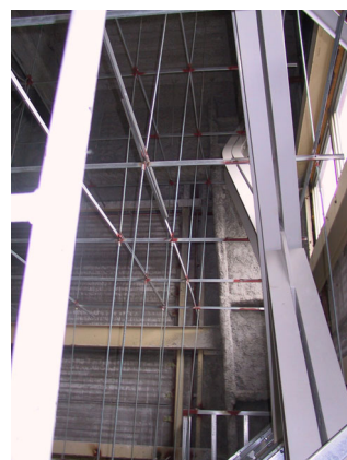
写真 6.89 ブレース材座屈(61)
