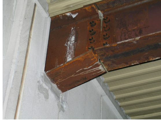
写真 6.148 梁継ぎ手部分のプレートの亀裂
