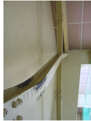
写真 6.107 ブレース材座屈 (構面内及び構面外) (4)
