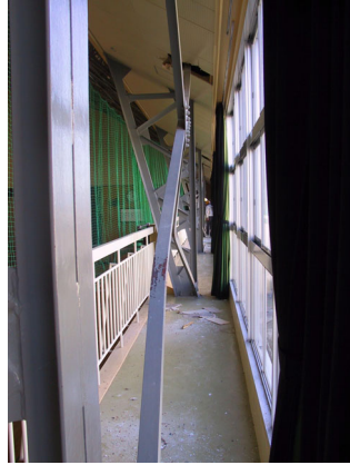
写真 6.25 ブレース材座屈(92)
