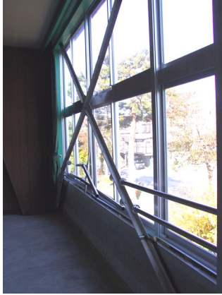
写真 6.9 ブレース座屈(26)
