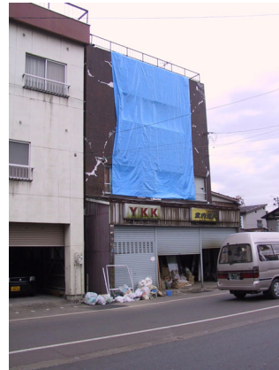
写真 6.117 外装材の被害
