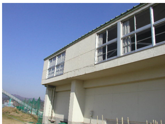
写真 6.127 窓の下の高さで水平に破損した窓の間の壁
