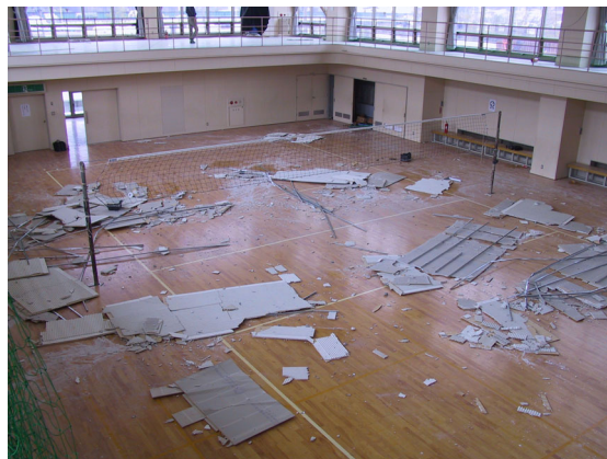
写真 6.82 落下した天井
