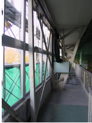
写真 6.71 ブレース材座屈(50)
