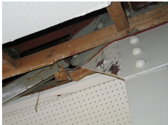
写真 6.121 ブレース材端部の破断及びガセットプレートの座屈
