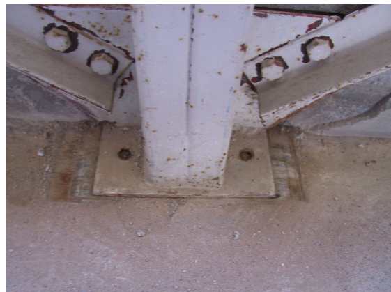
写真 6.8 間柱脚部ボルト破断、ずれの跡 (24)
