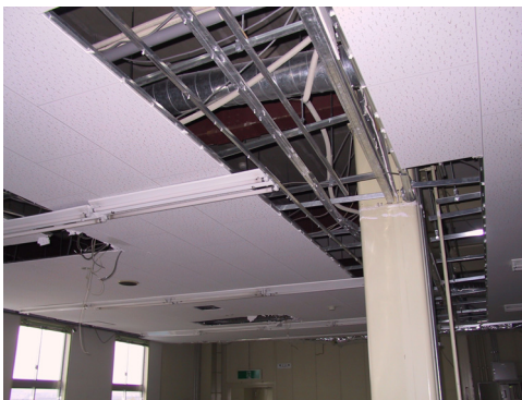
写真 6.113 天井一部落下
