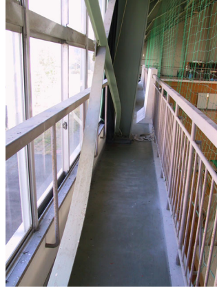
写真 6.47 ブレース材座屈(133)
