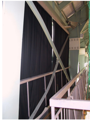
写真 6.49 ブレース材座屈(137)
