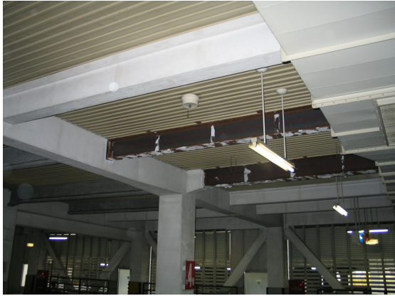
写真 6.147 梁被覆材の脱落
