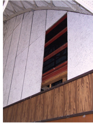
写真 6.12 舞台脇の仕上材一部落下
