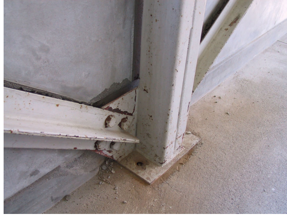
写真 6.4 間柱脚部アンカーボルト破断(16)
