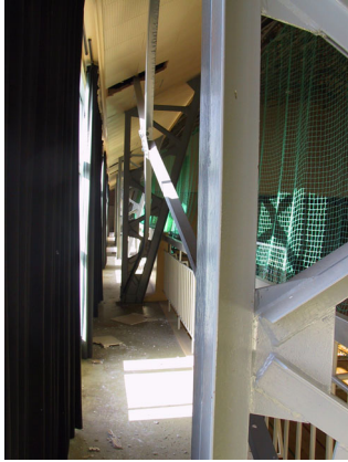
写真 6.31 ブレース材座屈(109)
