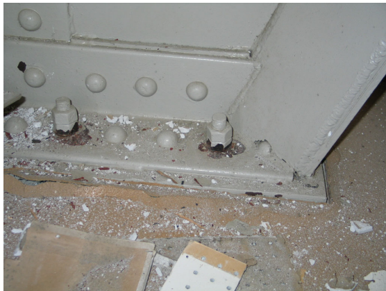
写真 6.124 柱脚アンカーボルトのすべり
