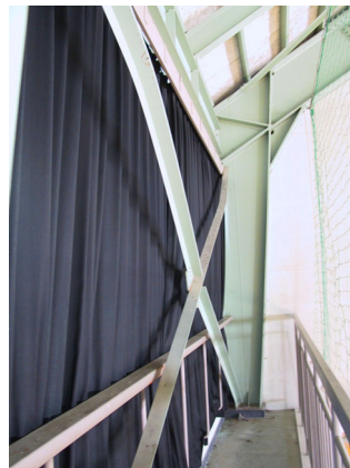
写真 6.51 ブレース材座屈(142)
