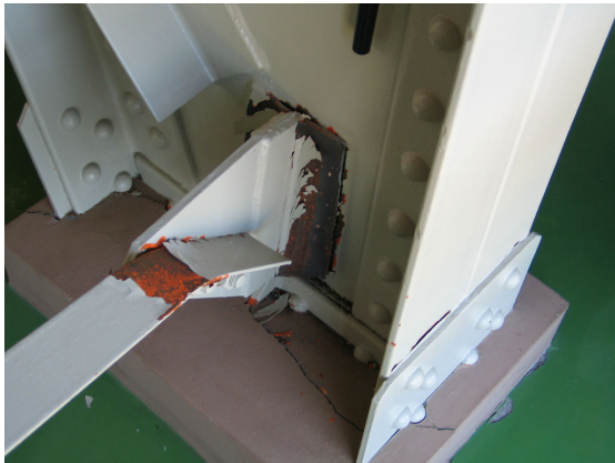
写真 6.132 ブレース材端部の塑性化及び 柱脚部コンクリートのひび割れ
