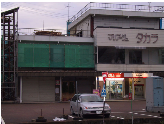
写真 6.118 外装材の被害
