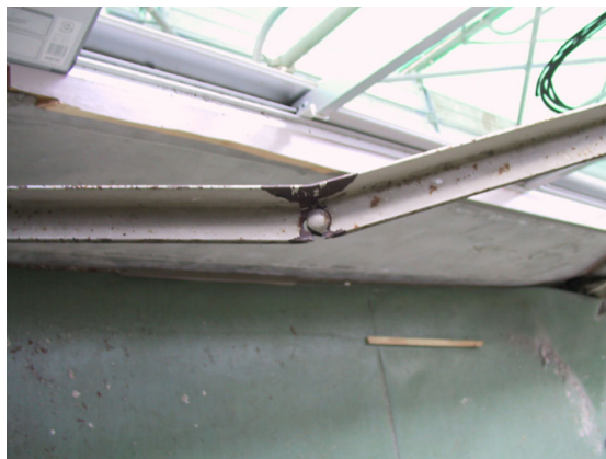
写真 6.69 ブレース材つづり部の亀裂(47)
