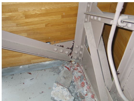
写真 6.142 ラチス柱の柱脚かぶりコンクリートの破壊とガセットプレートの降伏
