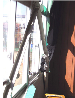
写真 6.14 ブレース材座屈 (37)
