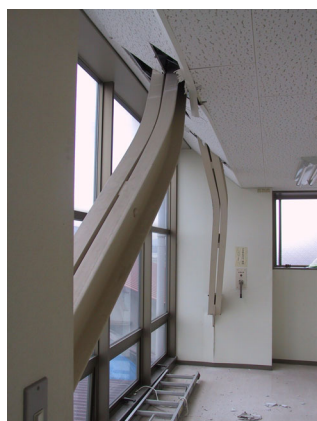
写真 6.87 ブレース材座屈(58)
